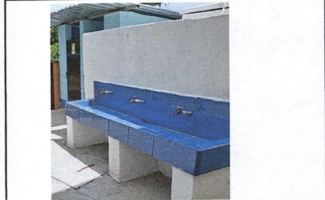
Foto 4: Lavamanos en funcionamiento.
